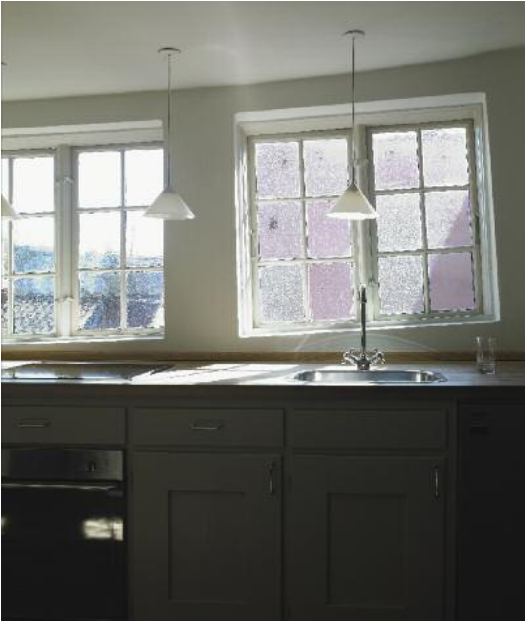
Køkkenet i mellembygningen. Gennem årene har bygningen sat sig og efterladt rummet med et markant fald.
