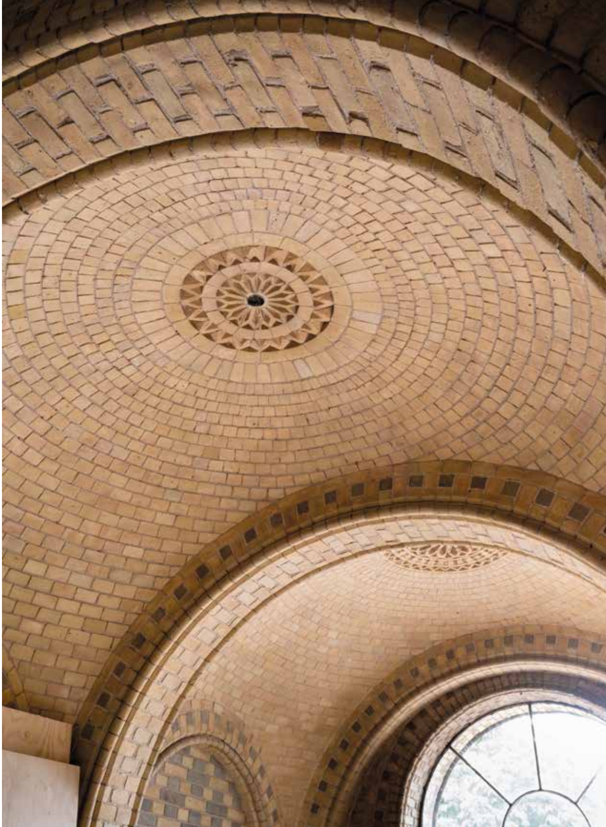
Vestibulen på Søetatens Pigeskole udgøres af tre murede hvælv, der får rummet til at minde om en lille kirke.
